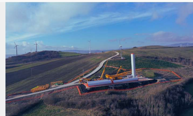
Impianto eolico Greci (AV)
